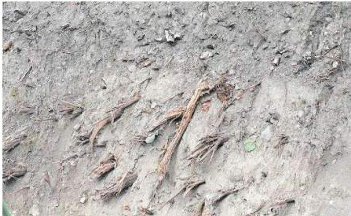
Der Schaden an den Wurzeln des Baumes in Zofingen. Bilder: zvg, rhu
